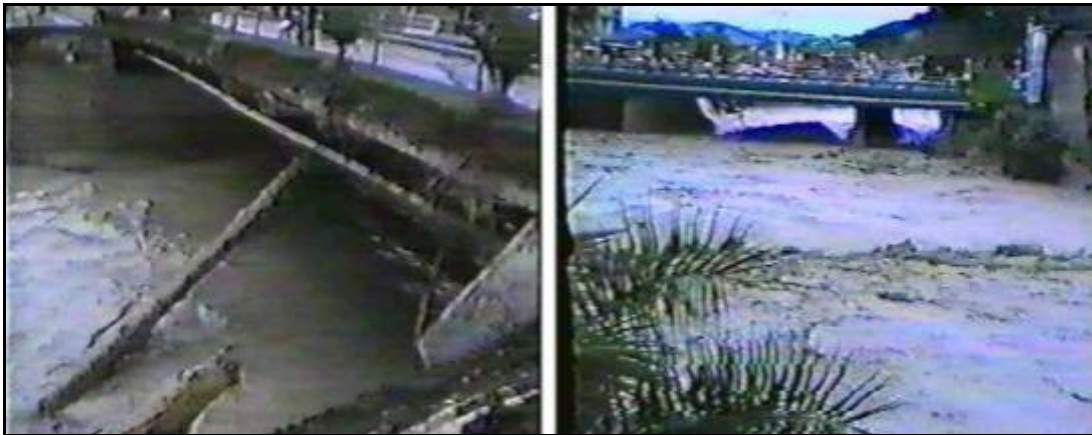
شکل ۱- خرابی پل در اثر سیلاب تیر ماه
