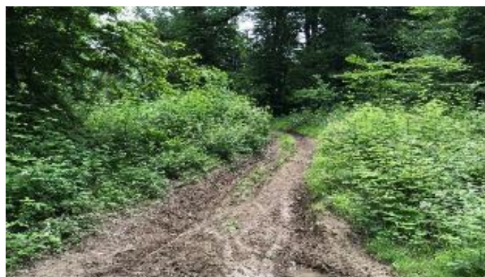
شکل ۹- نمایی از گرفتگی جوی کناری Figure 9. A view of the side drain blockage
