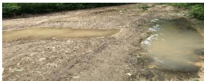
شکل ۸- نمایی از چاله‌های محدودکننده‌ی سرعت Figure 8. A view of the speed-limiting potholes
