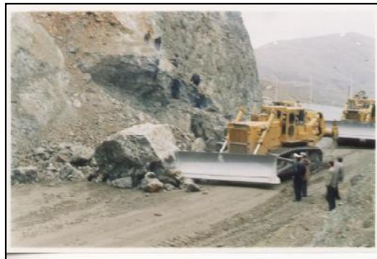
شکل ۱- ریزش سنگ‌های گردنه صلوات‌آباد هنگام پاک‌سازی جاده (لق‌گیری)
