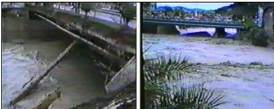
شکل ۱- خرابی پل در اثر سیلاب تیر ماه
