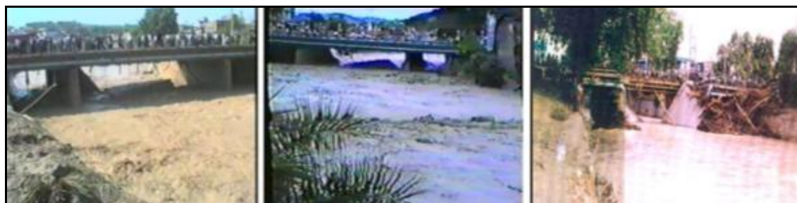
شکل ۶- تصاویر خرابی پل جهت تخمین میزان گرفتگی
